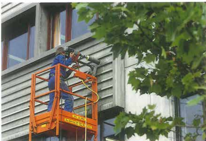
Figur 3. Udboring af betonkjerne til undersøgelse af skadesramt beton.
