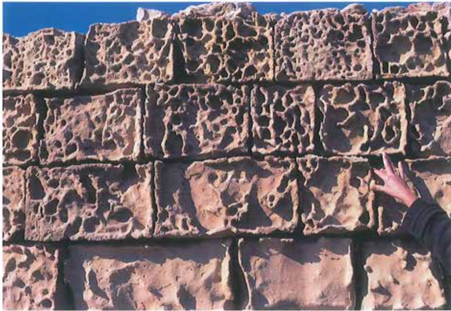
Figur 4. Forvitret mur i Victoria, Gozo, Malta.
