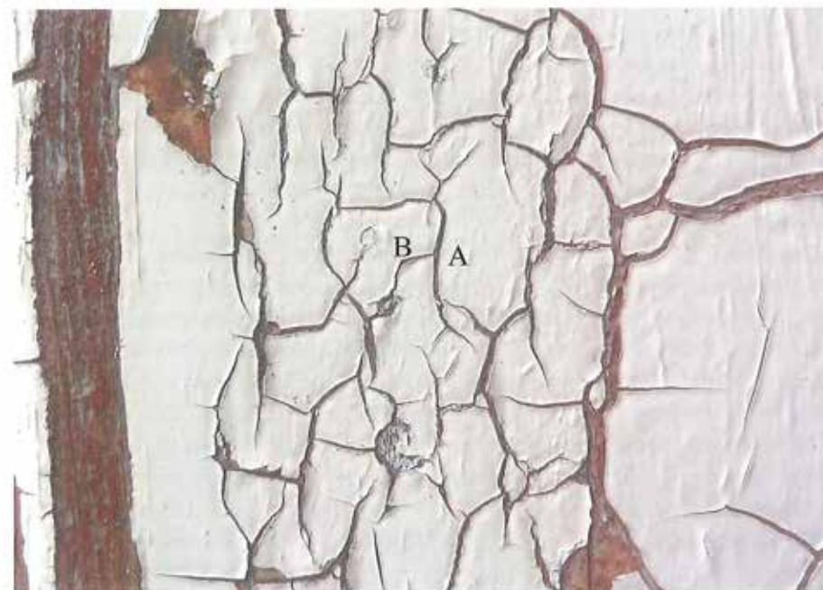
Figur 2. Sprækker i maling på dørkarm. Der kan ses mange generationer af revner opstået gradvis ved, at malingen skrumper og træet holder sin form.
