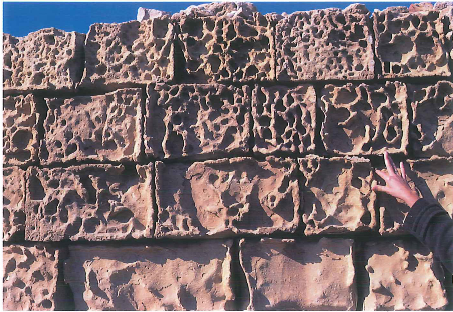
Figur 4. Forvitret mur i Victoria, Gozo, Malta.
